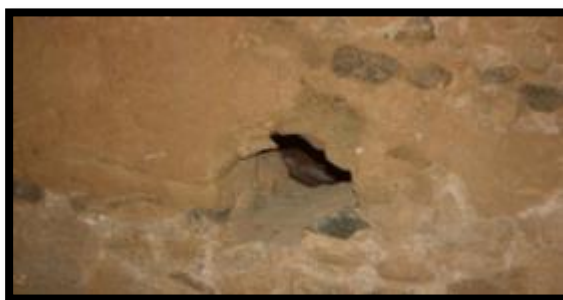
(Forat de les bastides per a la construcció de les parets a Can Ferrerons)
